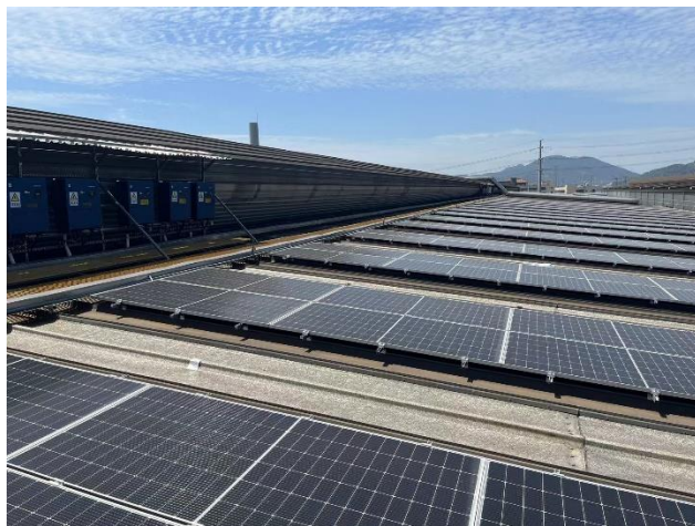
廈門廠房頂的分佈式光伏發電板
