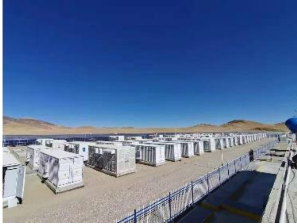
西藏崗巴縣大型光伏儲能電站項目
